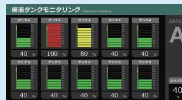
タンク残量監視
