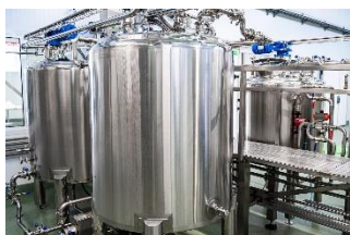
タンク残量監視
